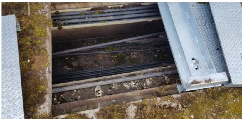
Artères de câbles
