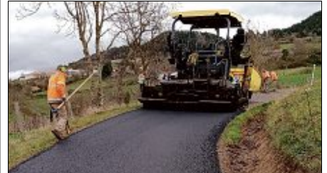
VOIRIE. L'entreprise Colas a été retenue pour remettre en état la voie communale.
