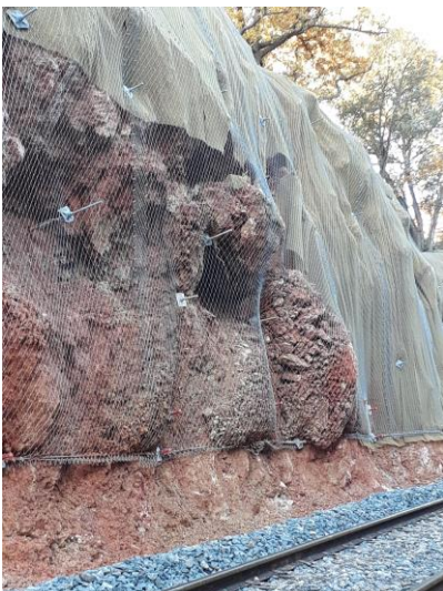
Premiers éboulements ayant été retenus par les grillages de sécurité
