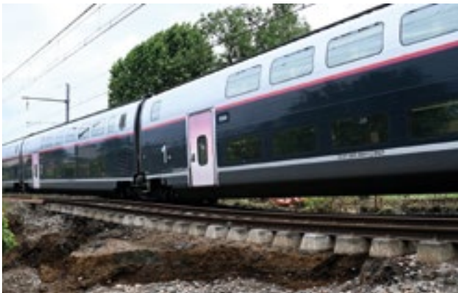
Remblai du ruisseau du Caillou à Tonneins - déraillement du 19 mai 2025
