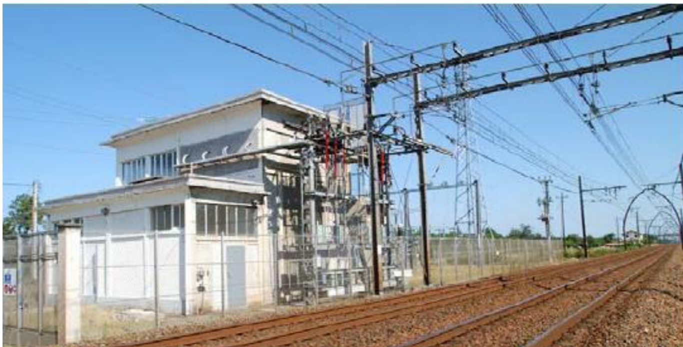
Exemple de sous-station d'alimentation électrique, sur la ligne Bordeaux-Hendaye (source : SNCF Réseau)
