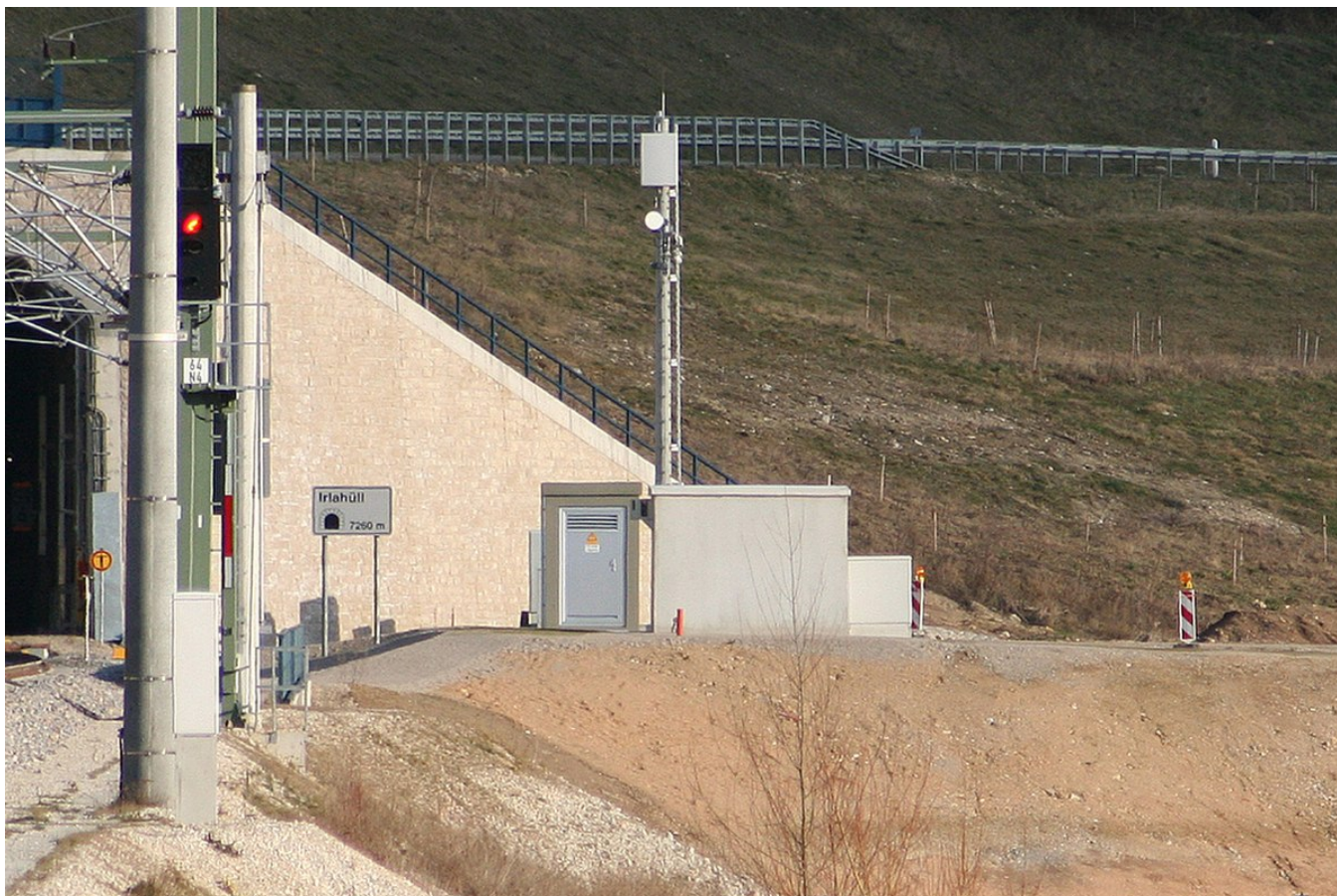
Mât d'émetteur de télécommunication ferroviaire
