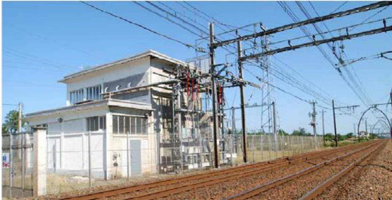
Exemple de sous-station d'alimentation électrique, sur la ligne Bordeaux-Hendaye (source : SNCF Réseau)
