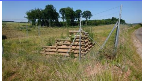
Échappatoire dont la hauteur entre le haut de l'échappatoire et la clôture est trop importante (©Egis)
