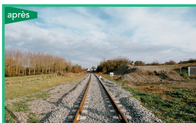
À Verneuil-sur-Serre , renouvellement des composants de la voie (rails, ballast et traverses)
