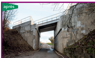
Remplacement du tablier du pont ferroviaire situé à Vervins au niveau de la route départementale n°1850P
