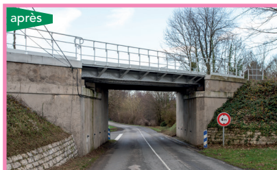
Réfection du pont ferroviaire situé à Vervins au niveau de la route départementale n°372
