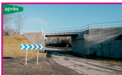
Remplacement du tablier du pont ferroviaire situé à Lugny au niveau de la route départementale n°617
