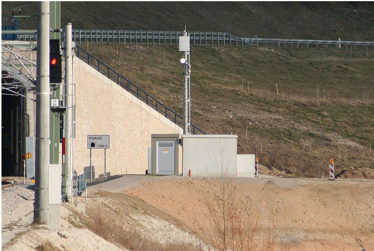
Exemple de mât d'émetteur de télécommunication ferroviaire
