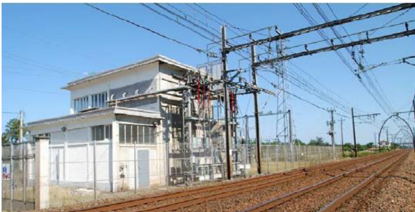
Exemple de sous-station d'alimentation électrique, sur la ligne Bordeaux-Hendaye (source : SNCF Réseau)
