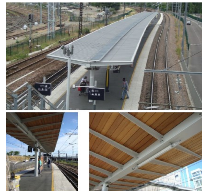
Figure 28 : Illustration représentative d'un abri filant en gare de Créteil Pompadour RER D (source : SNCF Mobilités)
